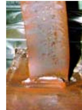
2. Lesione sull'ala più lontana dalla soletta in un giunto trave-colonna di struttura mista di acciaio e calcestruzzo
