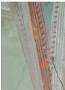
2. Castiglione Olona. Termocoppia per la misura della temperatura di superficie posta sulla vela di una volta Castiglione Olona. Termocouple for surface temperature measure on a vault
